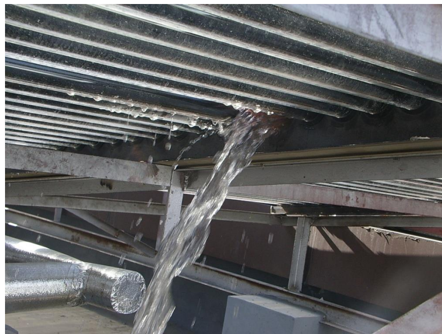
系统故障情况（漏水）
