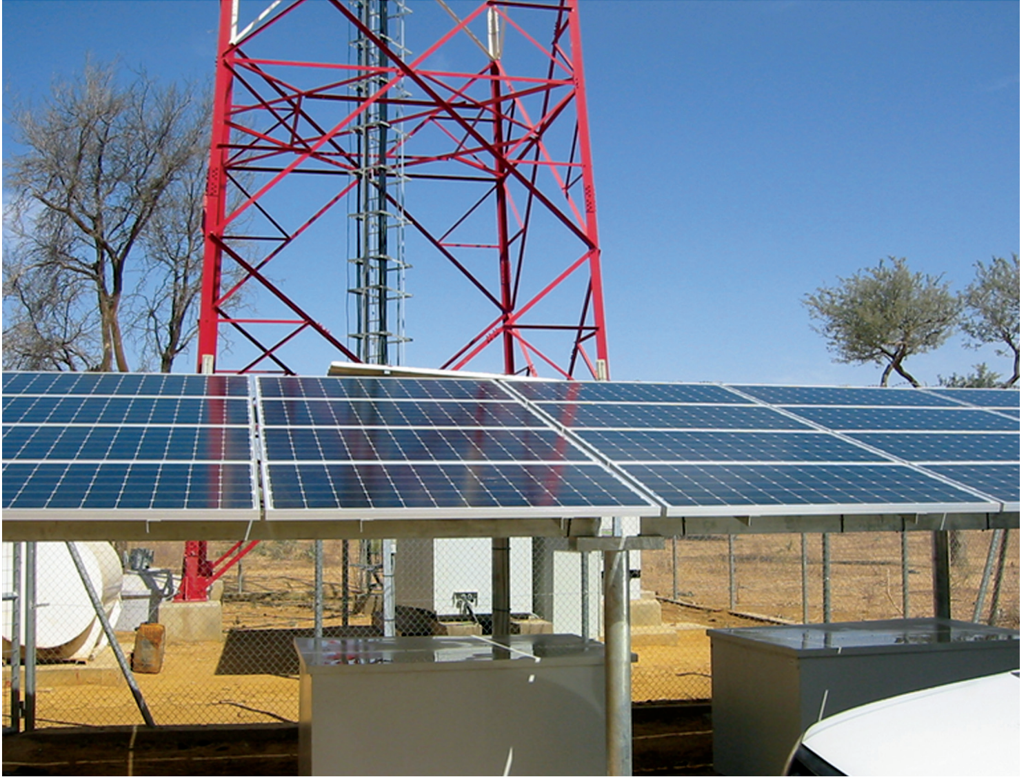
Système solaire photovoltaïque pour les stations de télécommunications Source: Airtel Niger
