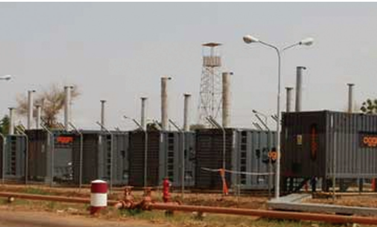
Centrale électrique à Niamey
